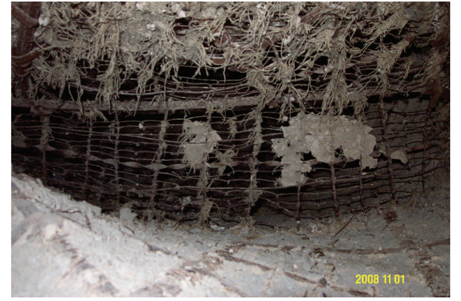
Detailaufnahme eines, vermutlich wegen einer Planänderung, nicht mit Zement versehenen Bereiches: die Reste der Ruffenbespannung sind noch gut erkennbar
